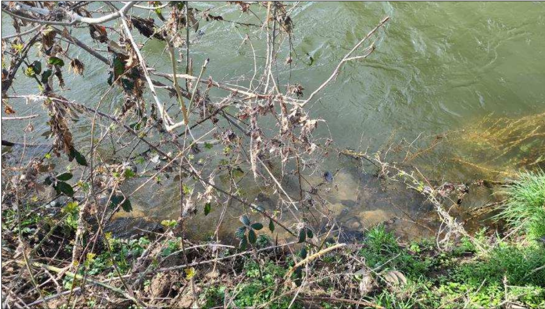
Abbildung 23: Ansicht der Ufersteine der Uferbefestigung unterhalb des Baufeldes. Da die Steinlücken Verstecke von Fischarten wie der Groppe sein können, sind Eingriffe in die Ufersteinschüttung zwingend zu vermeiden (hier im Foto vom 28.03.23 bei höherem Wasserstand gerade überspült; Pegel Menden 149 cm).
