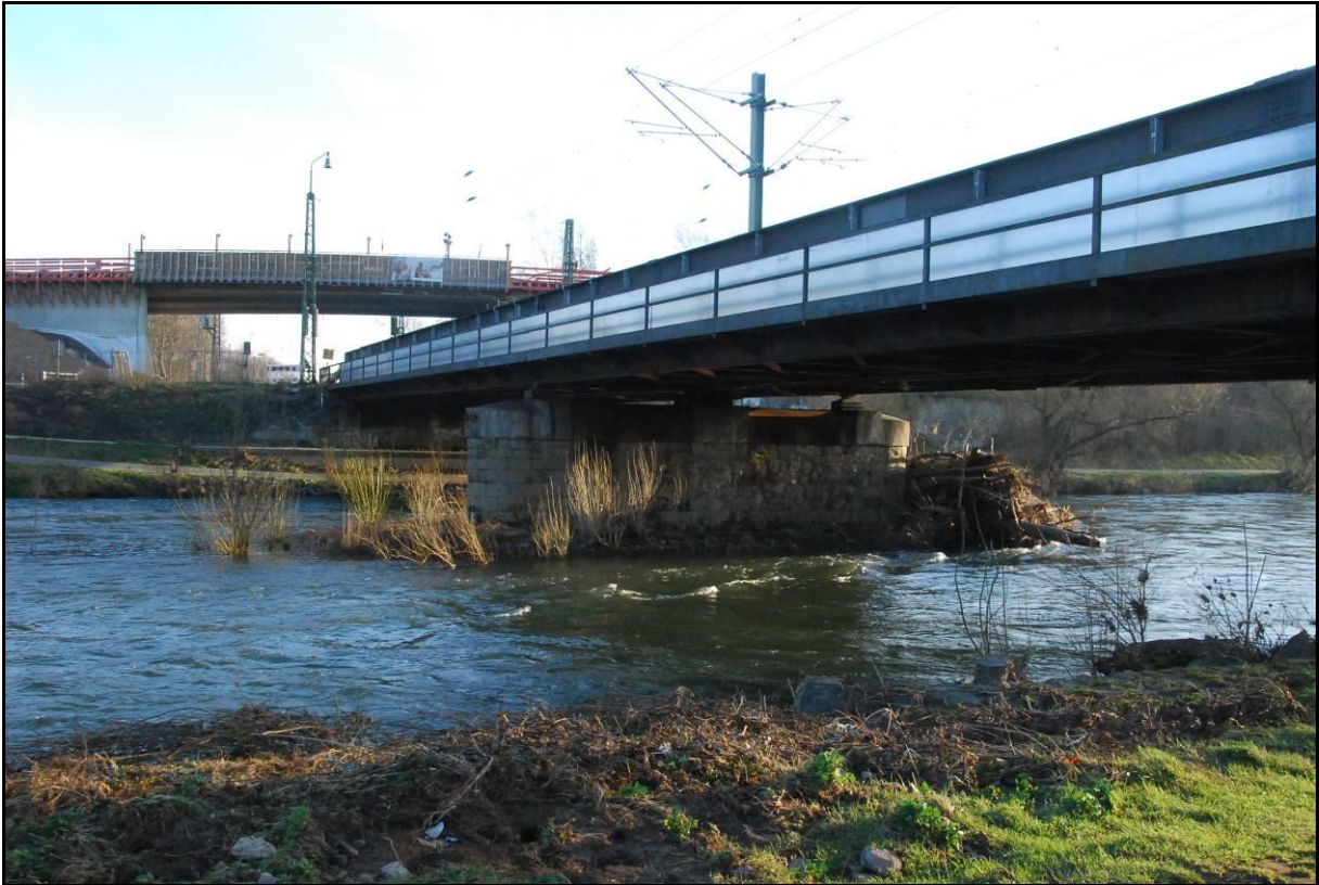
Abb. 6: Die Sieg im Vorhabensbereich (rechts im Bild) und westlich angrenzend bei hohem Wasserstand. Im Hintergrund ist der Siegtalradweg zu erkennen, der von Osten kommend die Baustellenzufahrt bildet.
