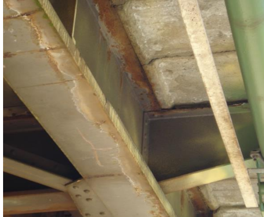
Bild 21: Korrodierte bestehende Konsole (EÜ Sieg) – Ostseite
