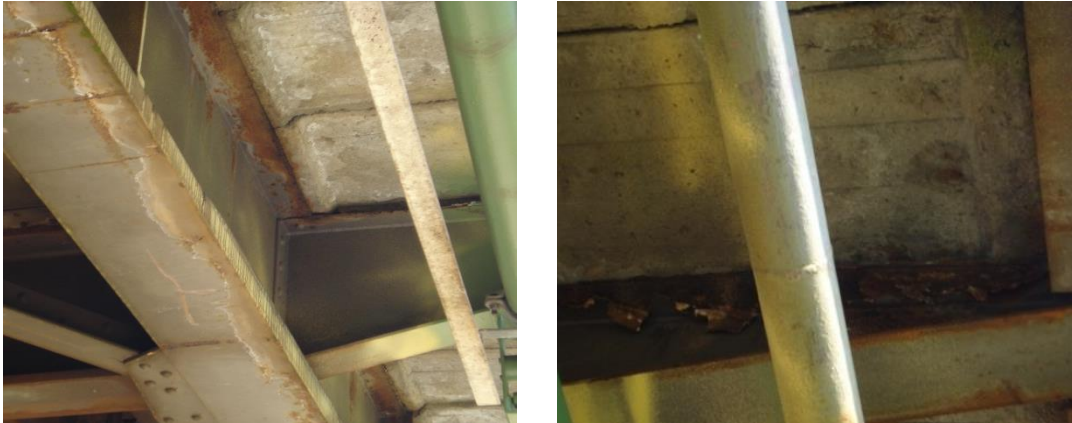
Bild 28: Korrodierte bestehende Konsole (EÜ Sieg) – Ostseite
